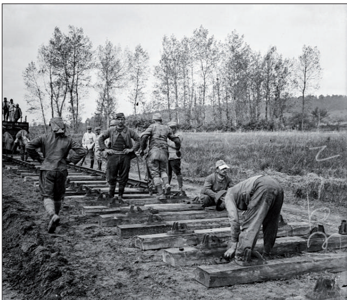
Pose des traverses d'une voie ferrée par le génie, Vailly, Aisne. @ ECPAD, M. Boulay.
